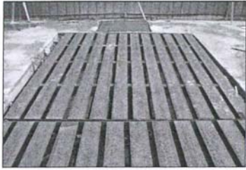
沉砂池及防溢座
