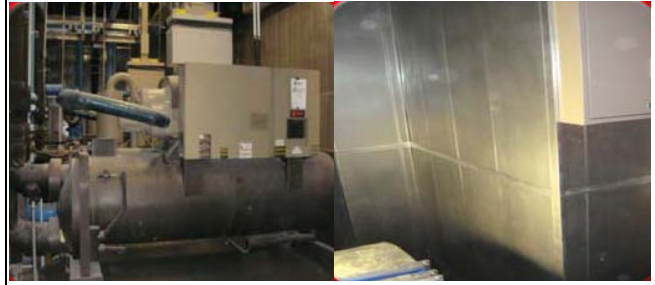
冰水主機設備
