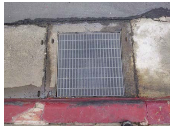
排水溝人孔防塵網
