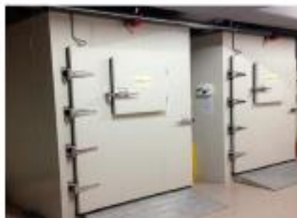
◎冷藏庫加垃圾壓縮設備
