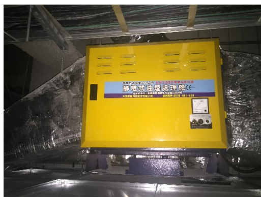
照片 2 靜電集塵器
