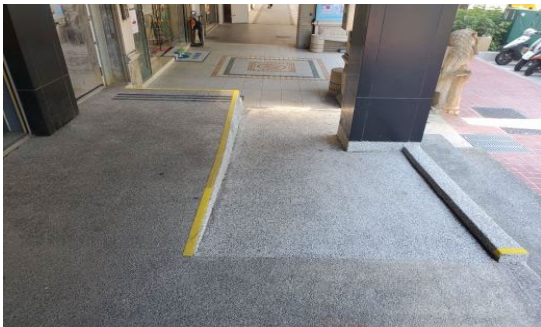
階梯及斜坡邊緣設置警示設施
