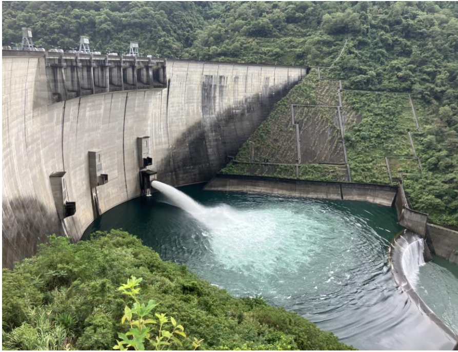
翡翠水庫調節放水，預降水位
