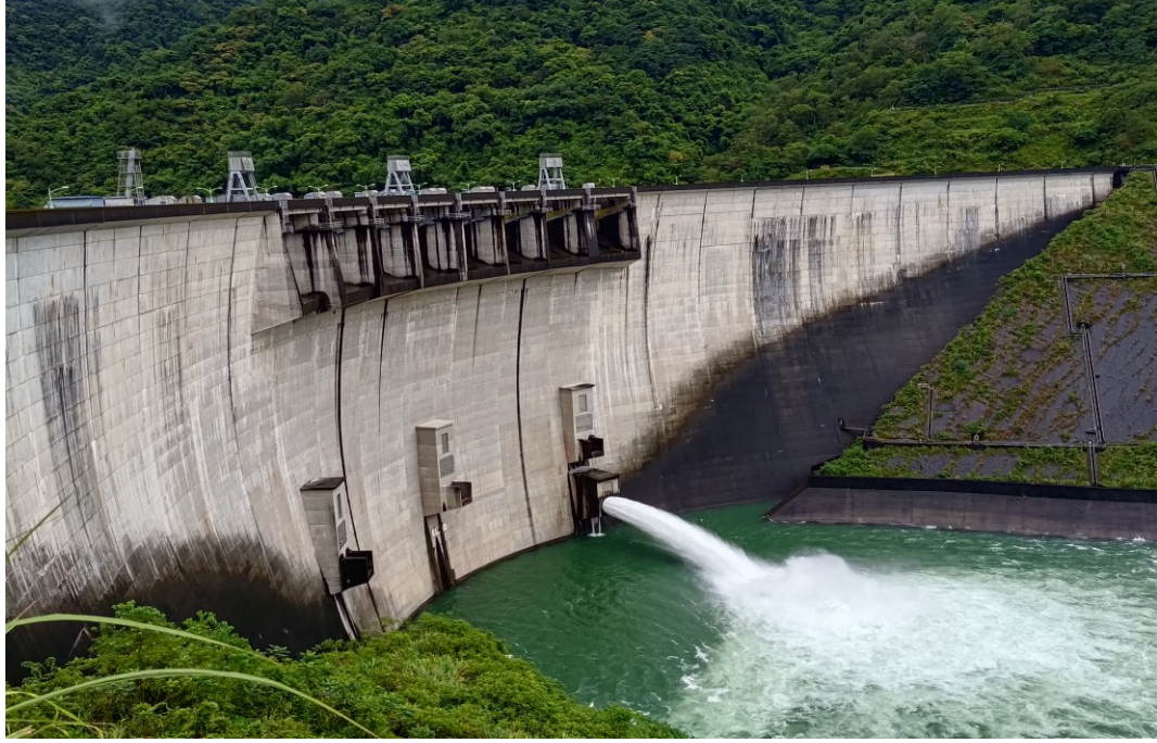
翡翠水庫「河道放水口」測試操作正常
