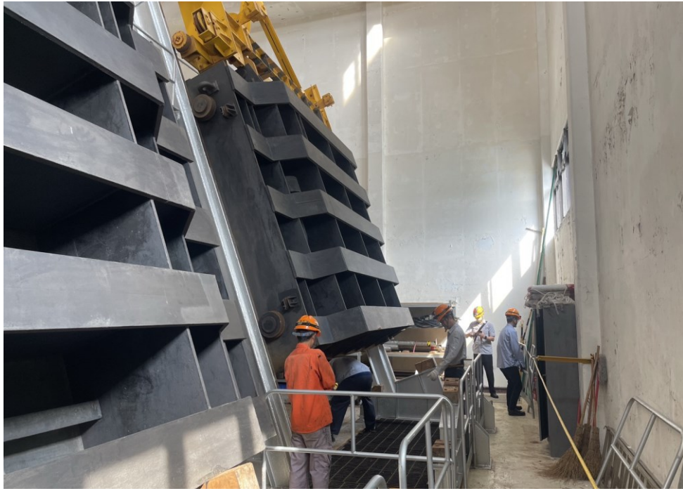
翡翠水庫「排洪隧道」水工機械測試操作正常
