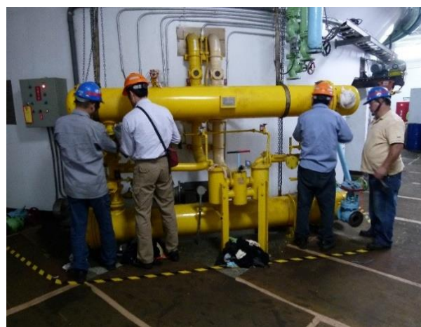
翡翠發電機組推力軸承油冷卻器維護
