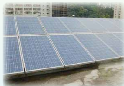
能源教室層頂架設太陽能板
