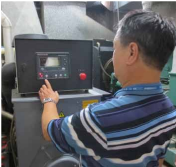
▲ 水電人員確認發電機、抽水馬達功能正常運作
