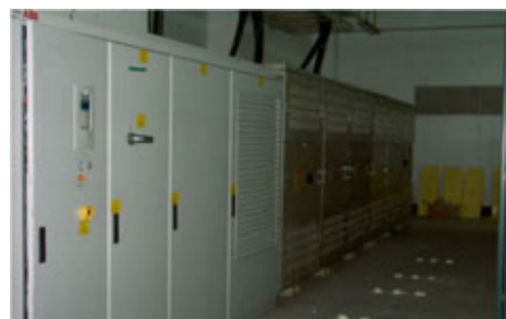
變頻器設備及中壓變頻器組3組
