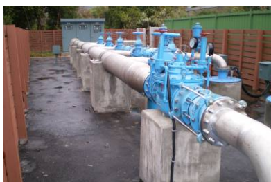
至善配水池加壓站出水管線
