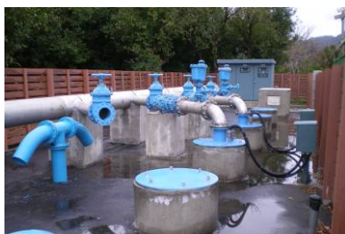
加壓站抽水支管
