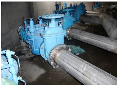
加壓站抽水機房全景
