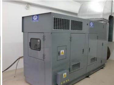
二原分水工緊急發電機
