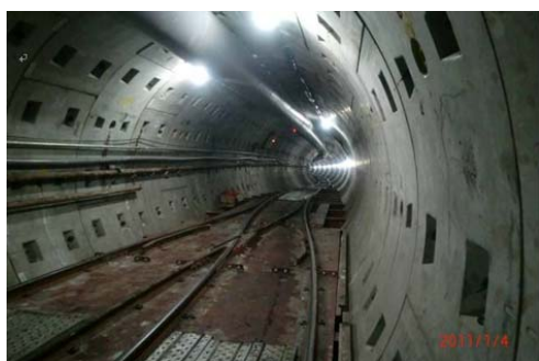
安華新店線隧道雙軌轉換器
