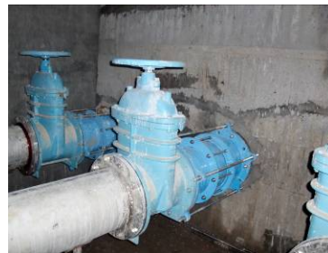
加壓站抽水桶進水管閘
