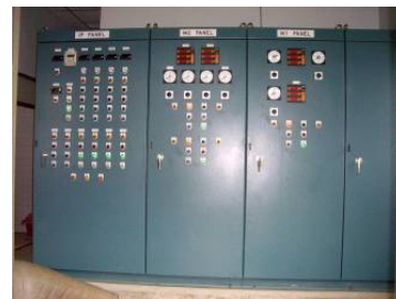
新設電力及儀控盤
