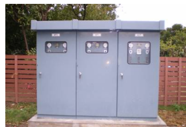
加壓站電氣儀控盤
