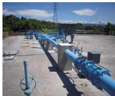
永嶺加壓站管閥設備全景 1
