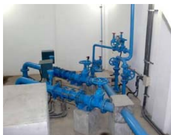
抽水機及出水管線
