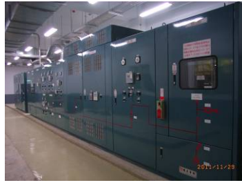
抽水機動力盤
