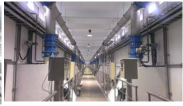
快濾池操作管廊
