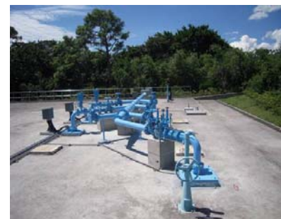
永嶺加壓站管閥設備全景 2
