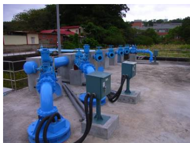
抽水機及出水管線
