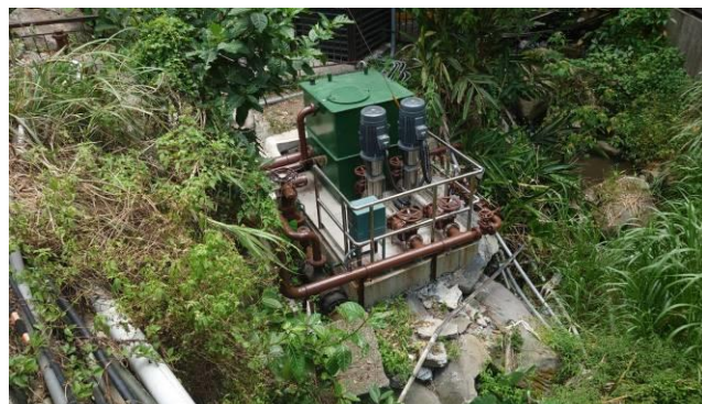
隧道水源加壓站
