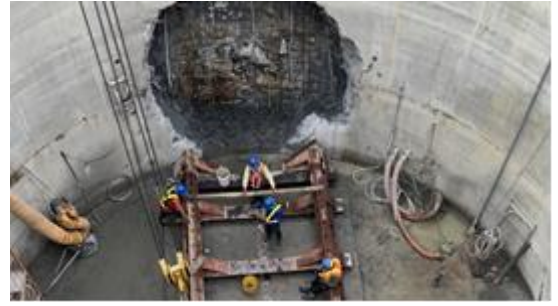
設備轉換(往消壓塔端)
