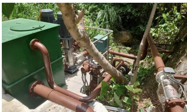
隧道水源水池、抽水機、流量計及管件
