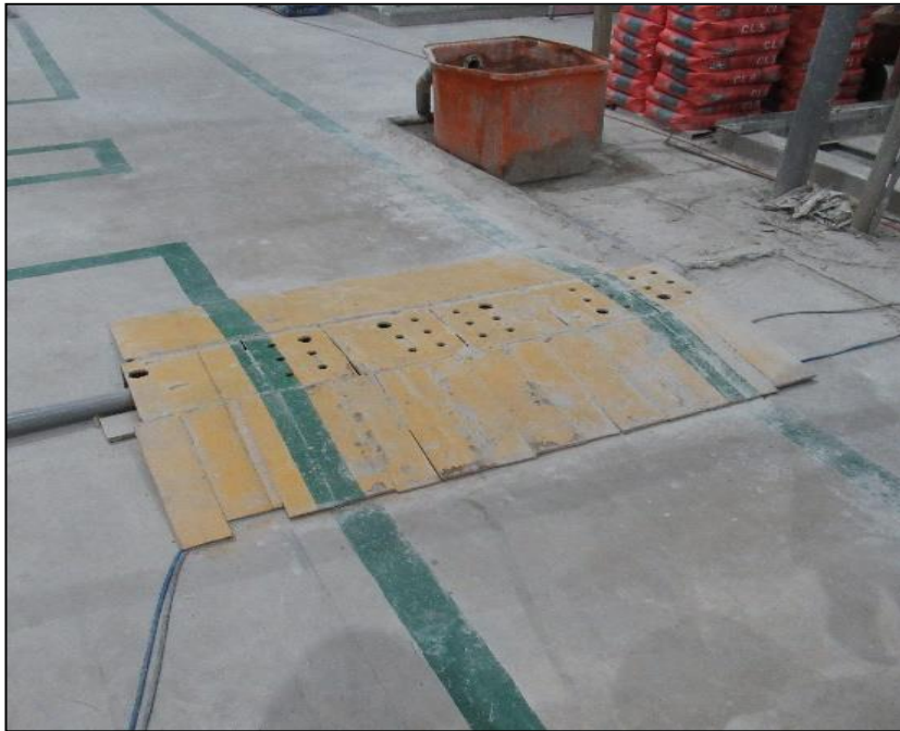
圖十八、電線置於保護板內以防車輛壓損破壞絕緣
