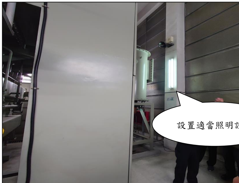
圖三十四、發電室應有足夠照明
