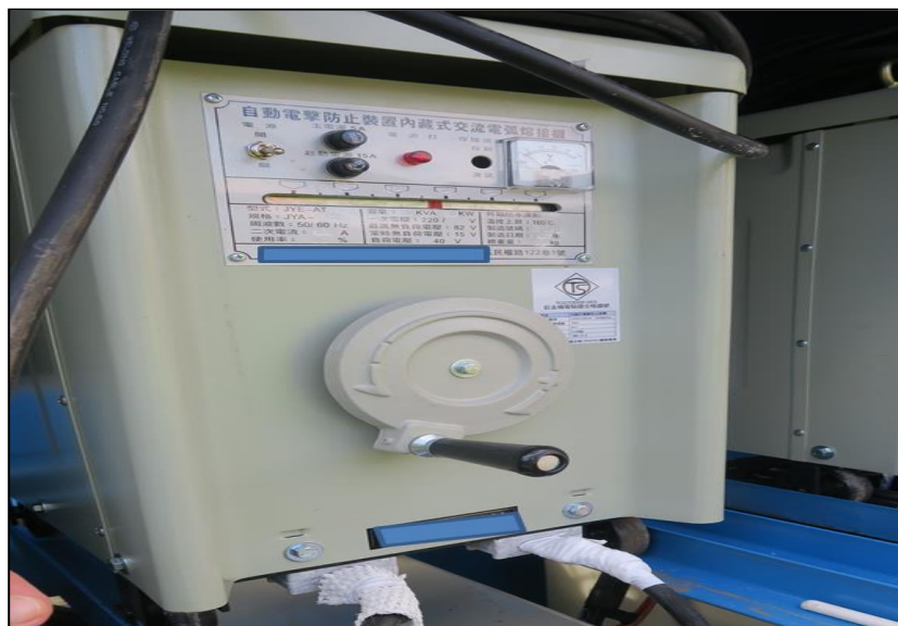
圖十五、 交流電焊機二次側應裝設自動電擊防止裝置
