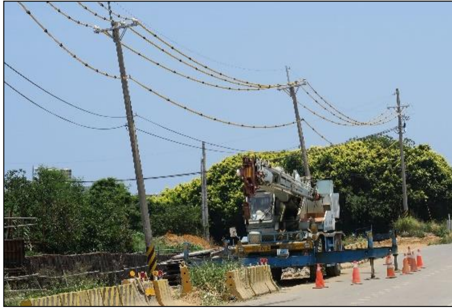
圖三十二、作業中物體可能接觸之高壓線路應 加裝絕緣套管
