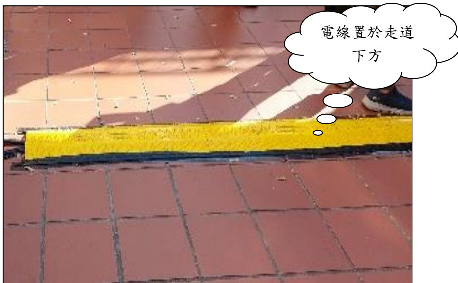
圖十九、電線置於走道下方以防人員踐踏破壞絕緣 法令依據：1、職業安全衛生設施規則第 246 條 2、職業安全衛生設施規則第 253 條
