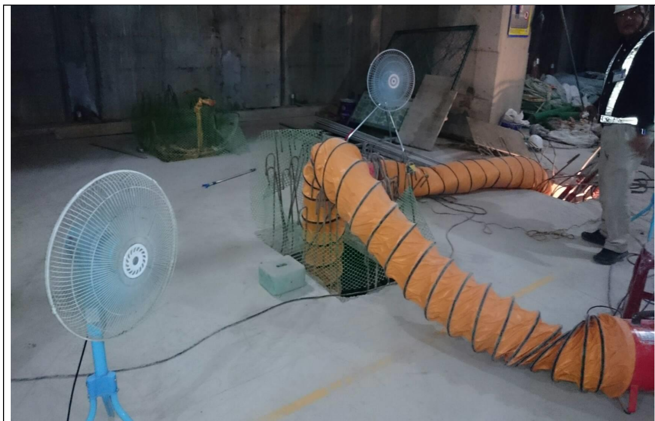
說明一 災後現場通風情形。
