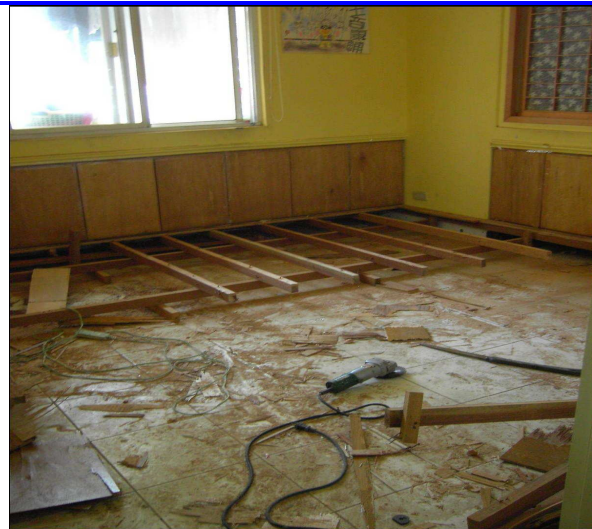
說明：現場使用電動圓盤鋸進行木板拆除。（未設置護罩之防護設備）
