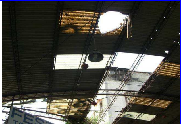
說明：現場屋頂被踏穿（未設踏板及安全網）
