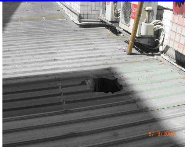
說明：現場屋頂被踏穿（未設踏板及安全網）
