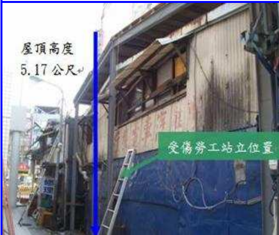
說明：未設置安全上下設備
