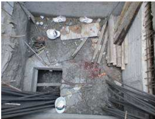
說明：電梯開口未設防護措施。
