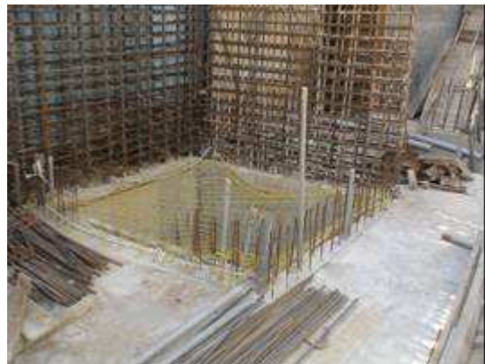
說明：電梯開口應設置防墜安全設施。
