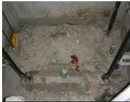
說明：罹災者自 1 樓墜落處。
