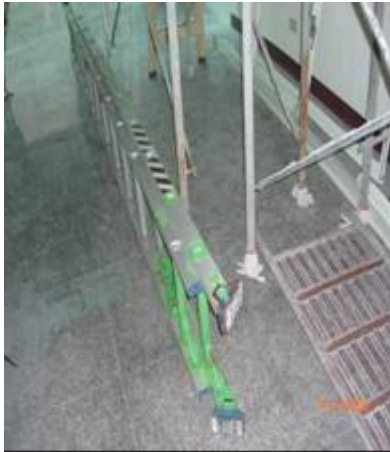
說明：現場使用之移動梯。
