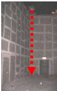
說明：罹災勞工踏穿天花板墜落地面。
