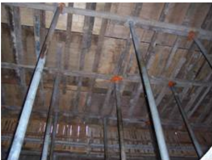
說明：1 樓施工平台(高 3.28 公尺)夾板堆置 100 片，因未加以固定而滑落，壓住下方勞工孫○○身體受傷。
