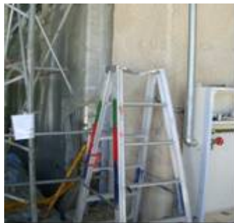
說明：現場所使用之合梯及損壞之情形。
