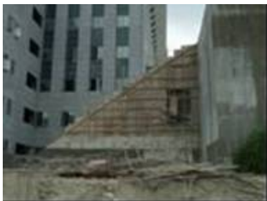
說明：施工架未在適當之垂直，水平距離處與建築物妥實連接。
