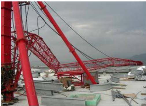
說明：A人字臂起重桿吊桿挫屈損毀狀況。
