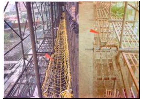
說明：施工架與結構體開口間隙應設置安全網或鋪設延伸踏板。
