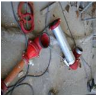
說明：現場掉落之消防管。
