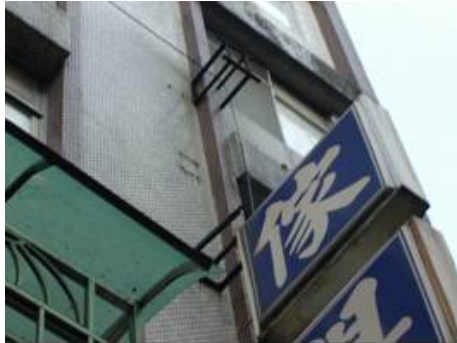
說明：連桿斷裂致招牌掉落。
