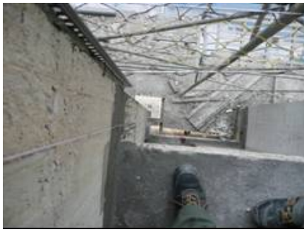
說明：黏貼泥作灰誌工作區塊施工架與樓板開口間隙未設防墜設置。
