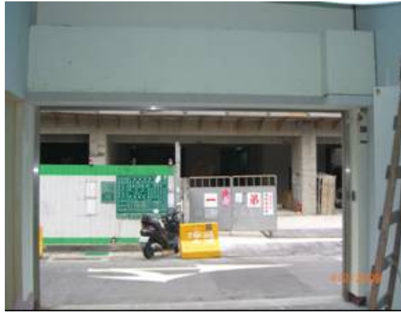
說明：大門上方牆壁油漆補土區域。
