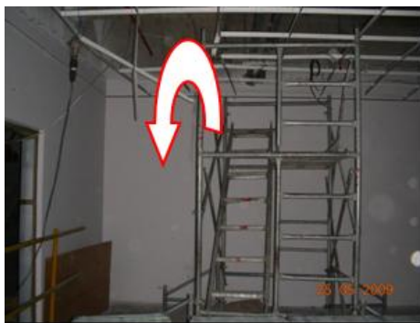
說明：勞工搭設中之施工架（於裝設四週護欄時墜落）。
