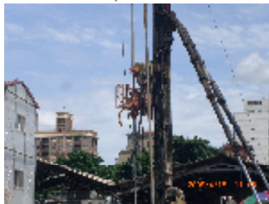
說明：勞工從事地質改良作業發生吊帶被旋轉中之鑽桿捲入受傷作業處。
