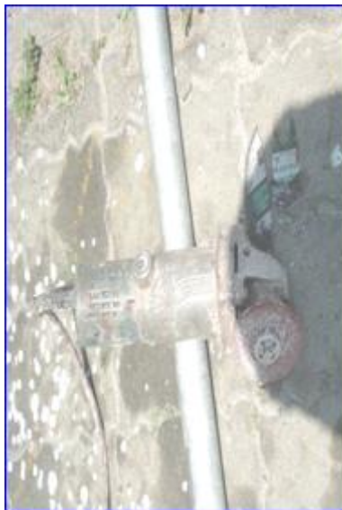
說明：切割機未設護罩。
