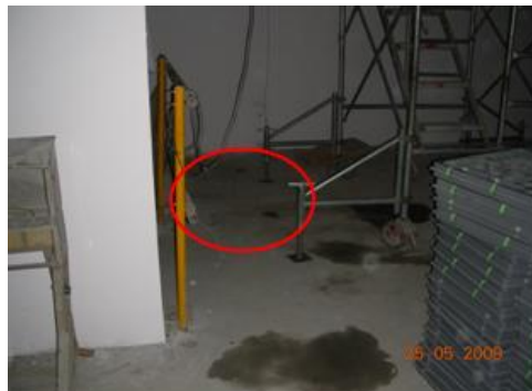
說明：勞工墜落之位置。
