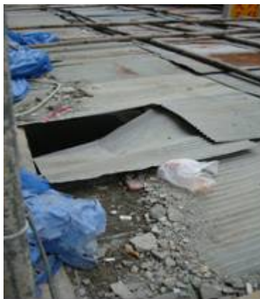
說明：勞工踏穿鐵皮棚處。
