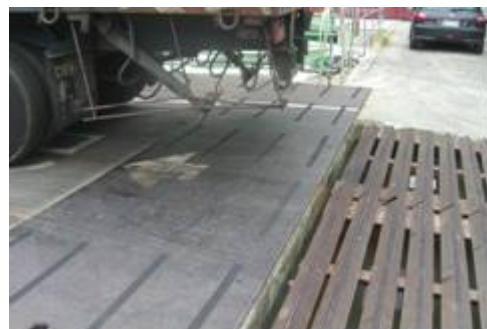
說明：工地通道鋪設之鋼板應具止滑性，或於鋼板上鋪設柏油、金剛砂等，以防人員滑倒。
