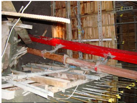
說明：水泥輸送管掉落至樓梯間面。
