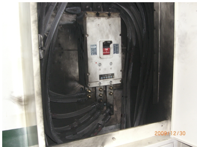
說明：電箱內煙薰情形。
