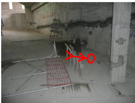
說明：現場使用不合格之合梯進行作業。
