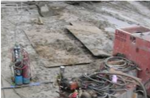
說明：工地現場鋪設之鋼板未採防止跌倒、滑倒之措施。
