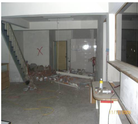
說明：災害現場照片（1 樓）。
