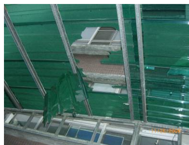
說明：勞工踏穿雨棚處。
