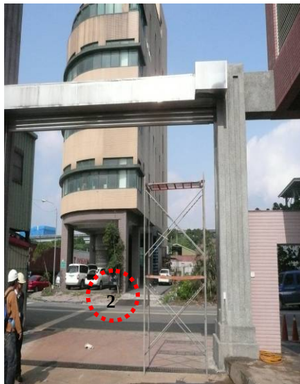
說明：施工架並沒有設置使勞工安全上下之設備。
