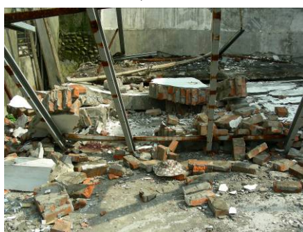
說明：現場倒塌照片。
