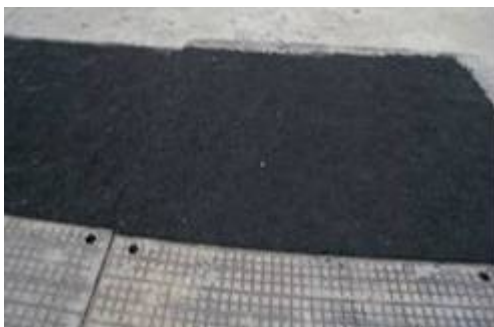
說明：工地通道鋪設之鋼板應具止滑性，或於鋼板上鋪設柏油、金剛砂等，以防人員滑倒。 22
