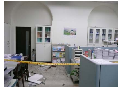
說明：罹災者墜落時天花板 破損散落於 2 樓地板。
