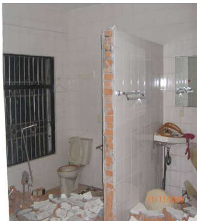
說明：災害現場照片（1 樓廁所）。
