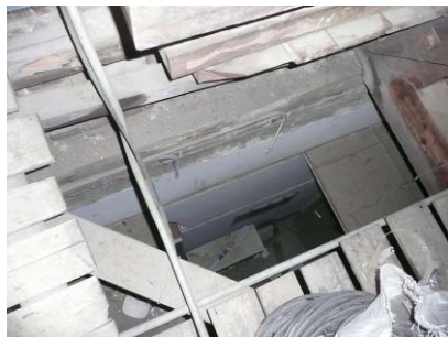
說明：貓道右側無防護設備。
