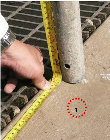
說明：鄭員當時於施工架（高度 3 米 4）上作業。
