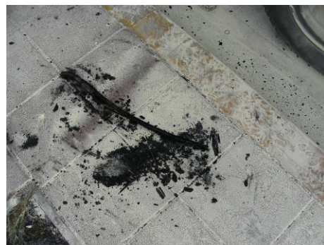
說明：破裂之瓦斯管線。
