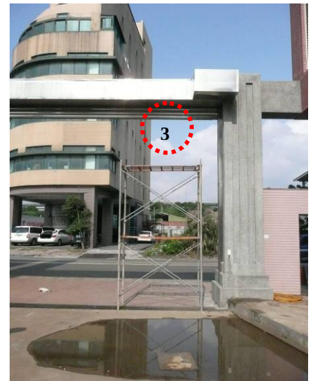
說明：鄭員當時於施工架（高度 3 米 4）上作業。
