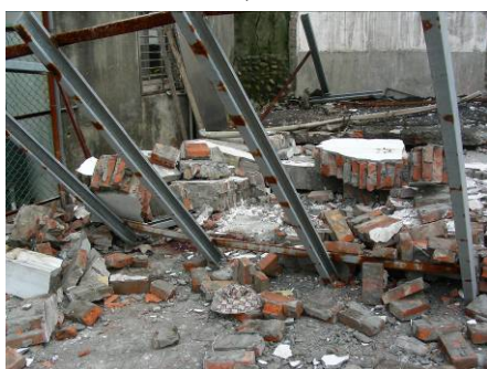
說明：構造物拆除未注意控制拆除構造物之穩定性造成磚牆倒塌。
