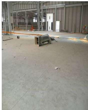
說明：掉落之風管掛架。
