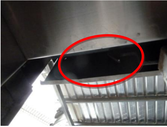
說明：升降機一樓乘場門連鎖裝置。
