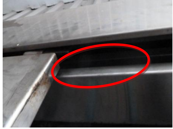
說明：升降機一樓乘場門連鎖裝置。
