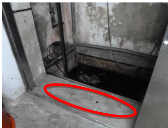
說明：勞工墜落於地下一樓機坑。
