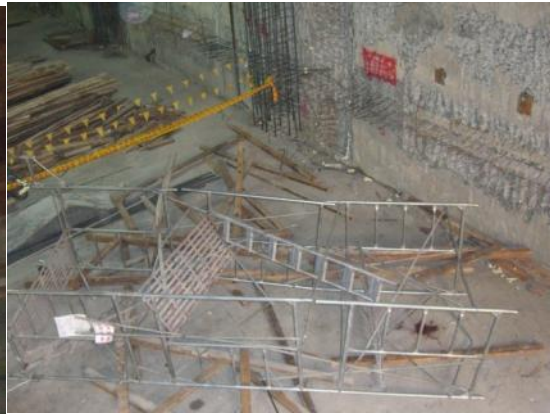
說明：現場移動式施工架倒塌情形。
