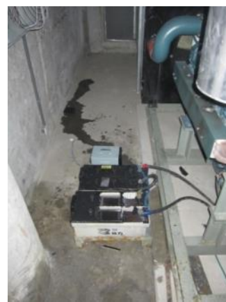
說明:現場發電機與電池
