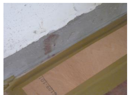
說明：室內裝修之施工現場。說明：勞工跌落時頭部撞擊牆面尚有血跡。
