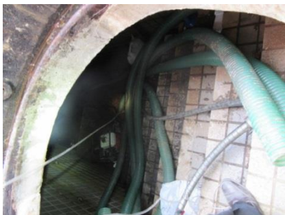
說明：災害發生現場（人孔下方）。
