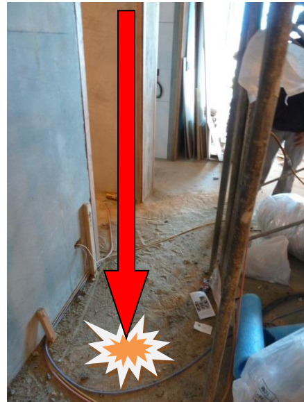
說明：現場墜落情形。
