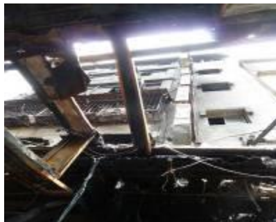
說明：嬌○有限公司火災後現場
