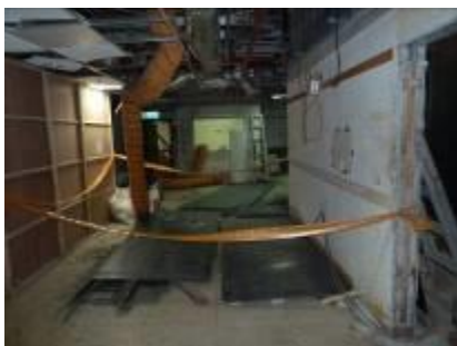
說明：職災發生現場。
