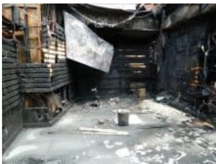
說明：裝修作業火災後現場。
