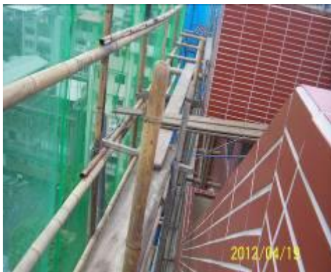
說明：現場施工架（竹架）開口未設防墜設置。
