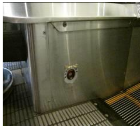
說明：電扶梯緊急停止開關
