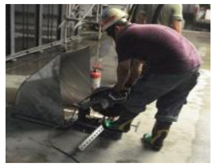
說明：使用切割機從事切割鐵材作業，應設置預防火災之設備（擋板及配置滅火器）。
