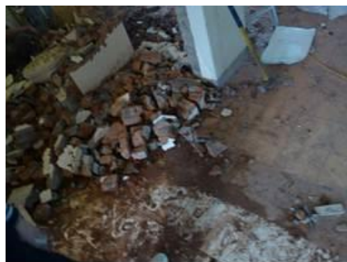
說明：現場所使用之合梯梯腳間無固定繫桿
