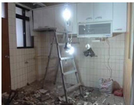
說明：作業勞工遭現場掉落之混凝土塊砸傷
