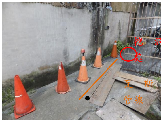
說明：瓦斯管線漏氣處與挖洞處約距1.5公尺。
