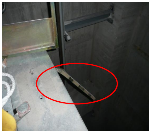
說明：左側伸縮桿挫曲彎折
