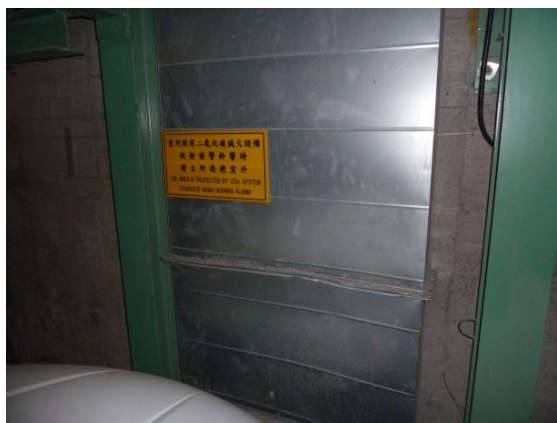
說明：緊急通風換氣設備。
