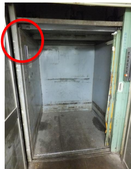
說明：升降機乘場門未裝設連鎖裝置(車 廂不在該樓層，卻能打開乘場門)。
