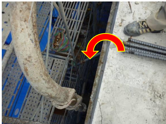
說明：勞工自施工架與建築物結構體間開口墜落（寬約35公分）。
