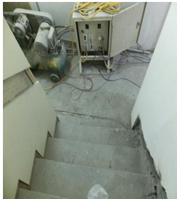
說明：勞工於行走時， 跌倒現場。
