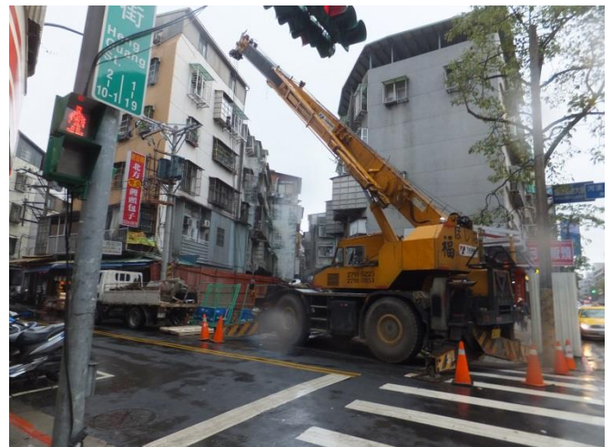
說明：移動式起重機過負荷裝置手動解除。
