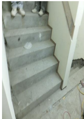
說明：勞工於行 走時，跌倒現 場。
