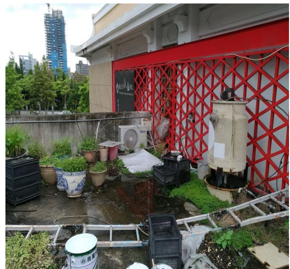
說明：移動梯未採取防止滑溜及轉動之措施。
