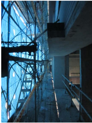
施工架開口未設防墜設施。
