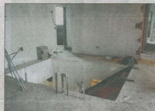
民眾家屋屋宇時被自增設室內梯連通，為常見的違規項目之一。圖／建管處提供
