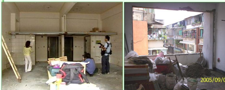
▲擅自搭建夾層屋或拆除陽台外牆，均屬違章建築行為
