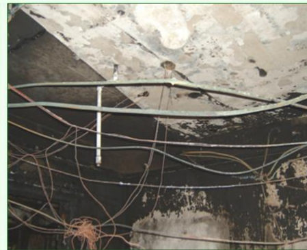
▲室內裝修施工過程擅自剪斷火警警報系統並封閉灑水頭致災案例
