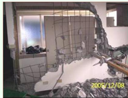
▲室內裝修涉及分間牆變更者，結構安全應經開業建築師簽證負責。
