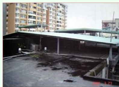
▲老舊、漏水建築物得申請於屋頂版上加蓋一定規模以下的斜屋頂。
