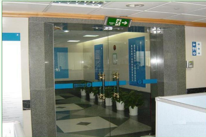
▲將防火門擅自更改為玻璃門，形同破壞防火區劃
