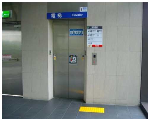
電梯外圍標示
