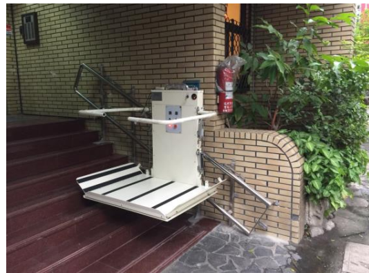
出入口設樓梯附掛式輪椅昇降平臺
