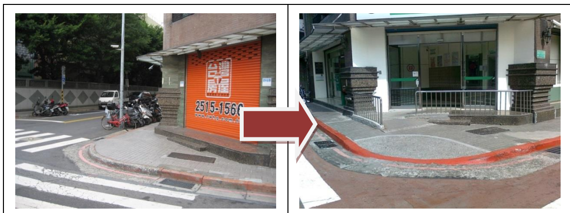
坡道高低差處理(改善前)
