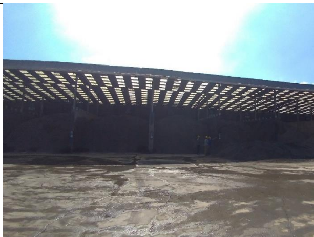
焚化再生粒料貯存區
