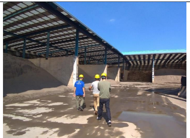
焚化再生粒料貯存區
