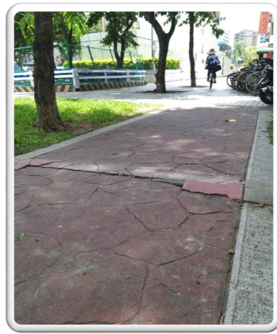
伸縮縫交接處隆起破裂
