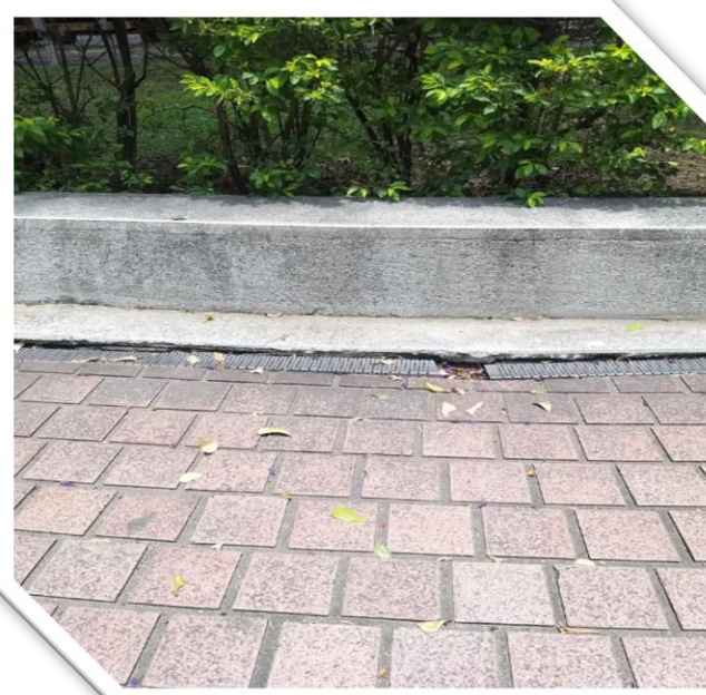
路緣斬石收邊隆起不平及破損
