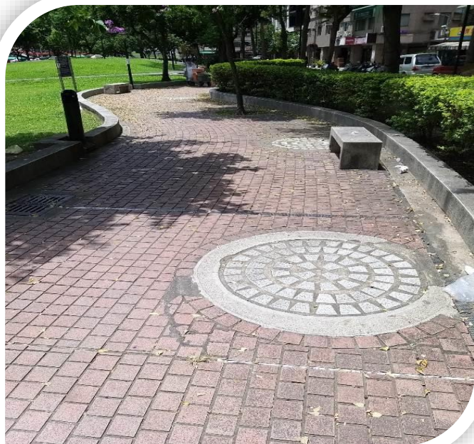
舊樹穴填平後造成隆起及破損
