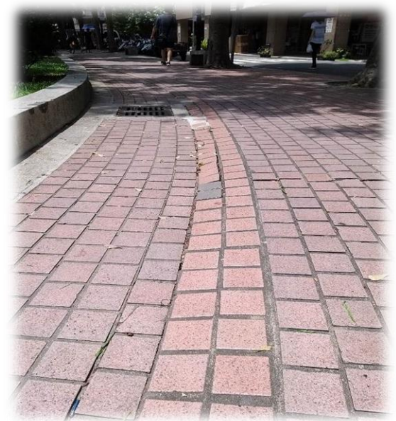
水溝外地坪隆起
