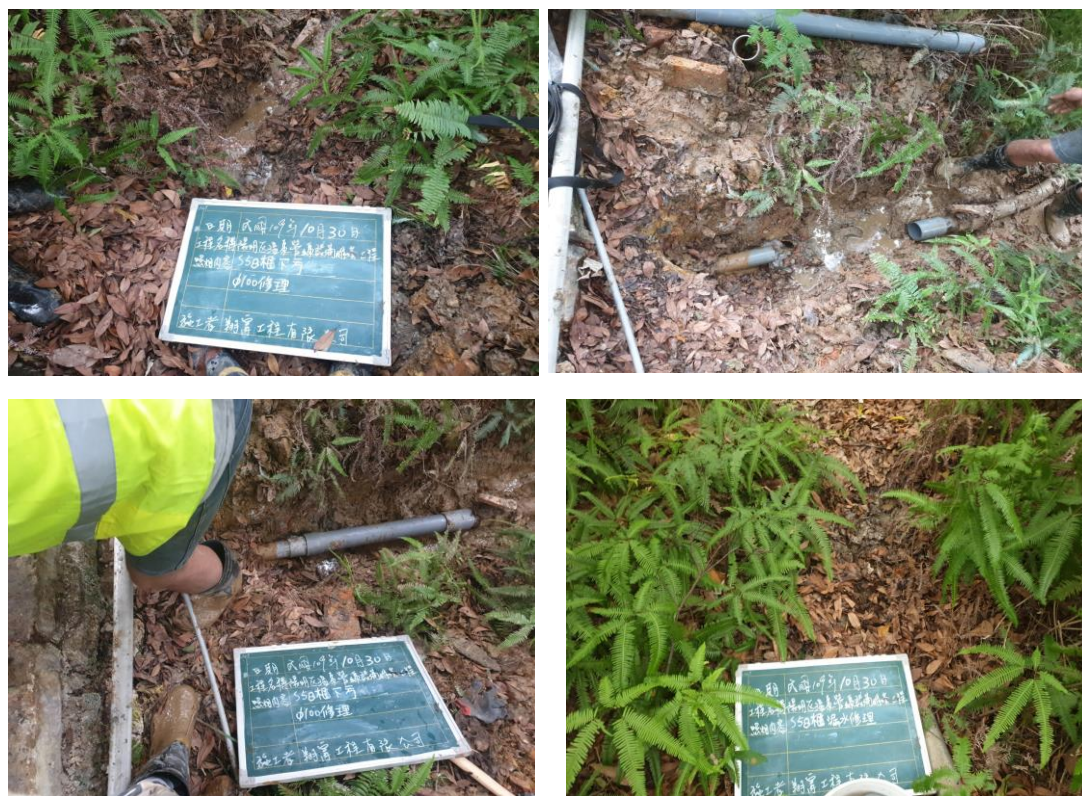
圖 3-6 山區邊坡滑動導致管線漏損
