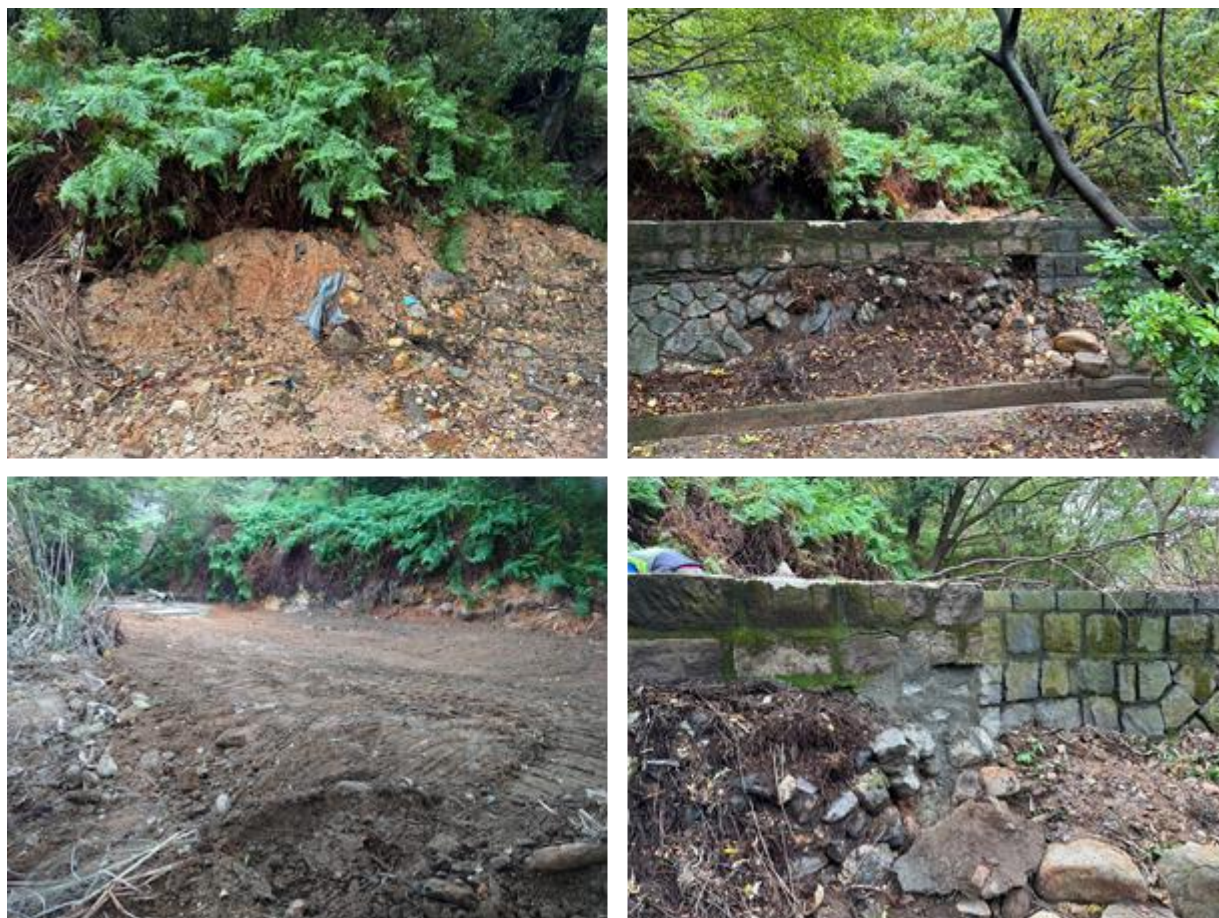
圖 3-17 暴雨後硫磺谷邊坡坍塌整修
