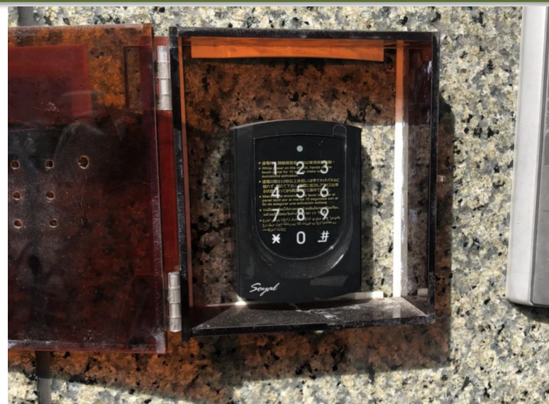
管委會門禁系統 安裝後
