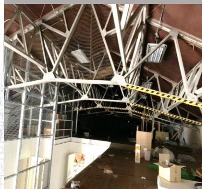
倉庫鋁製桁架
