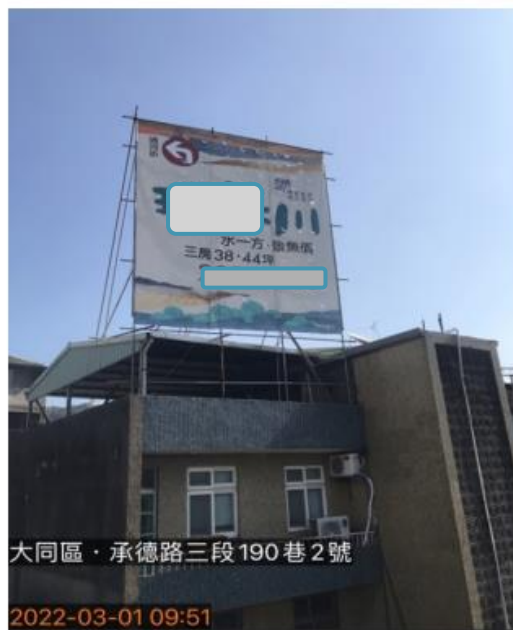
位於違建上屋頂鋼管鷹架樹立廣告
