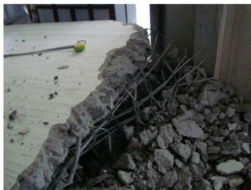
說明：倒塌之牆面下方已先打除。
