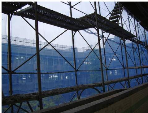
說明：施工架開口（內側未設交叉拉桿及下拉桿）。
