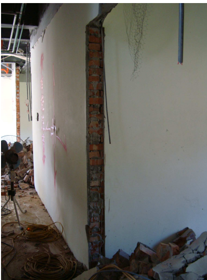
說明：倒塌牆面區。
