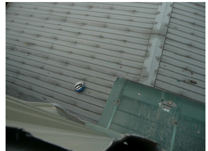
說明：罹災者墜落至隔壁屋頂。
