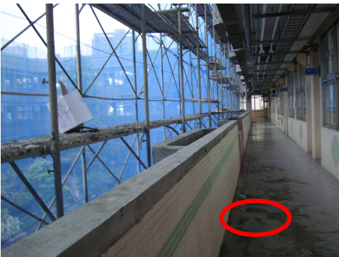
說明：勞工墜落處。
