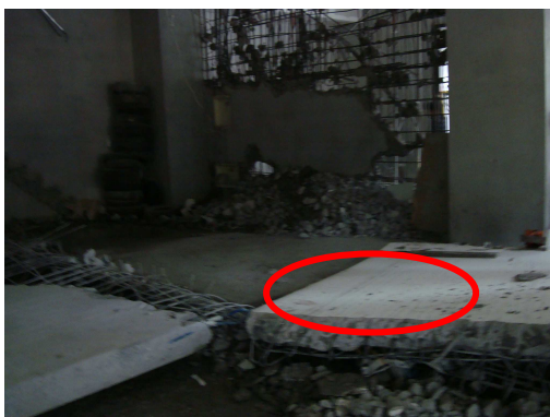
說明：災害現場照片（紅圈處為倒塌之牆面）。
