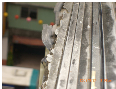
說明：窗緣結構未保持穩固。
