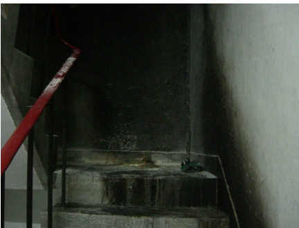
說明：火災現場實景。
