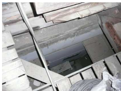
說明：貓道右側無防護設備。
