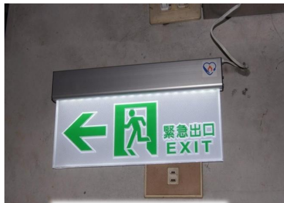
節能省電照明設備
