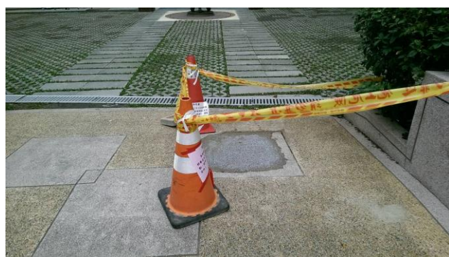
涉及公共安全的設施損壞，公園處亦派員協助第一時間處理。
