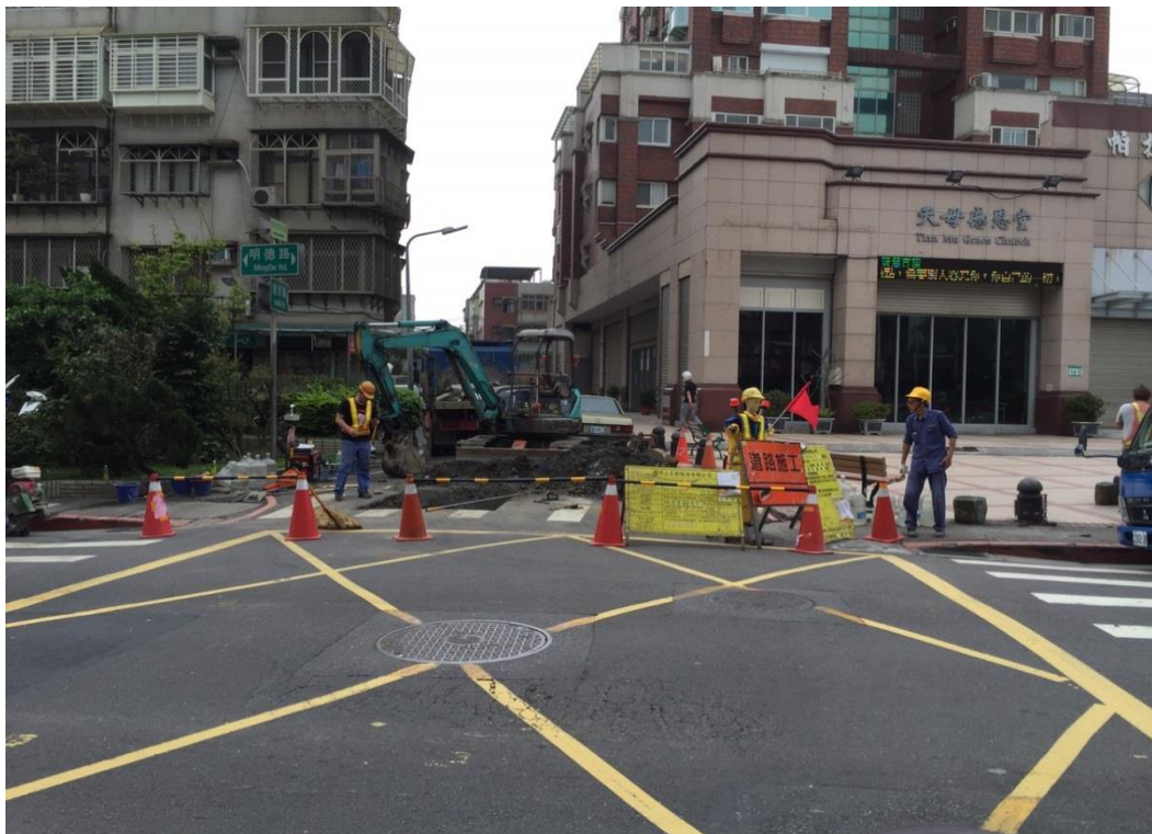
4/4 08:10 第 4 處疑似漏氣點開挖(明德路、建民路口)
