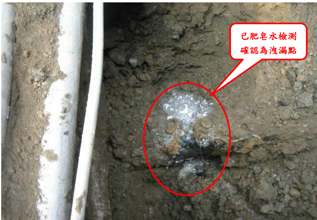
4/4 15:05 發現正確瓦斯漏氣點(明德路 176 號前)
